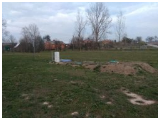
Przydomowa oczyszczalnia ścieków
