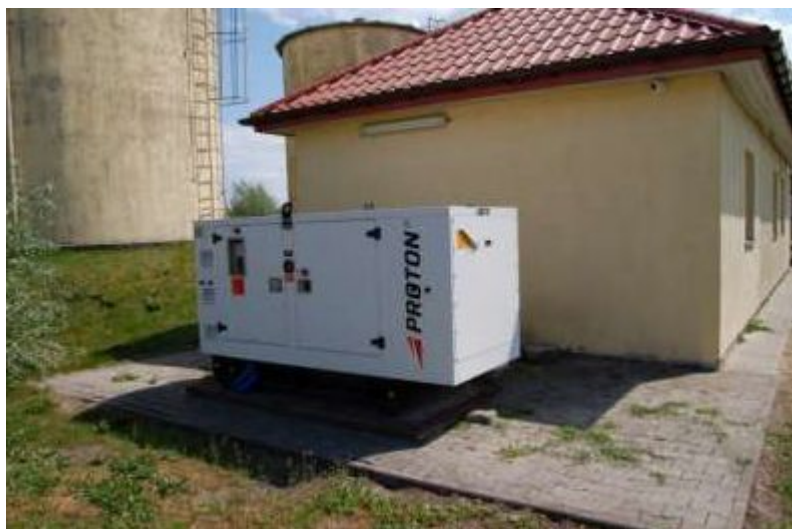
Nowy agregat prądotwórczy w SUW w Kocku
